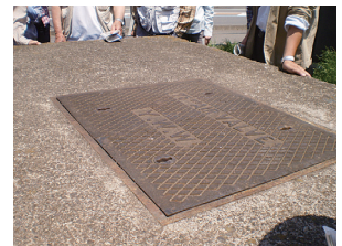
②横浜水道道エアバルブのふた
