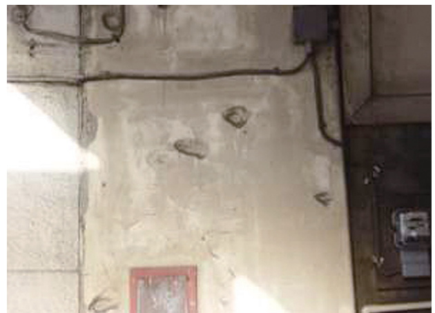
国道駅壁面には機銃掃射の弾痕が残る
